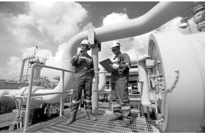
国营天然气(PGN或PGAS)公司天然气设施内的工人活动情景。
