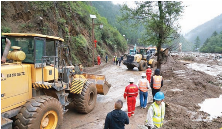
8月8日，救援人员在榆中县马坡乡山洪灾害现场抢修中断道路。新华社发（金万贵摄）
