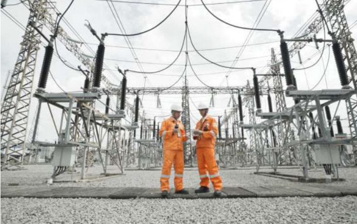
Cikarang Listrindo Tbk (POWER) 的员工正在检查输电网情景。
