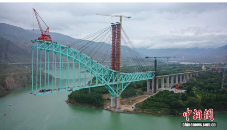
8月22日3时许，川青铁路青海段尖扎黄河特大桥发生施工绳索断裂事故。图为尖扎黄河特大桥。（无人机照片）张忠革 摄
