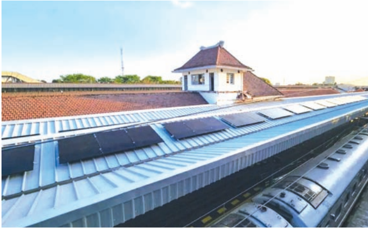
印尼铁路公司在多个地点安装了光伏发电系统。
