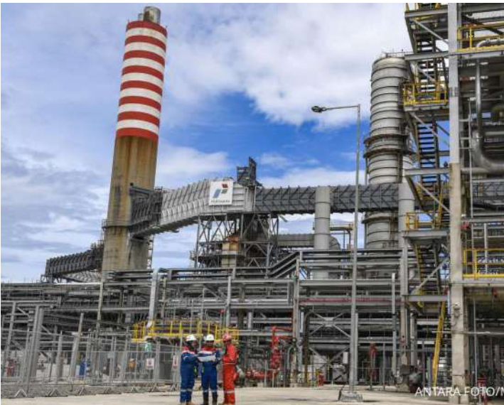
印尼国家石油公司(KPI)宣布, 巴厘巴板RDMP项目即将进入试运行阶段。
