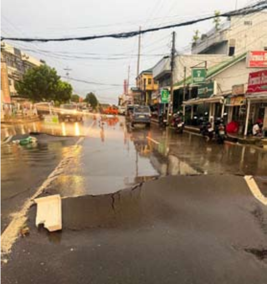
这是10月1日在菲律宾宿务省拍摄的在地震中损坏的道路。新华社发(宿务省地方政府供图)
