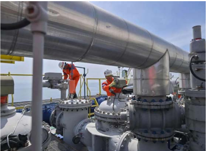
Pertamina Hulu Energi Offshore North West Java (PHE ONWJ) 员工正在检查天然气管道。
