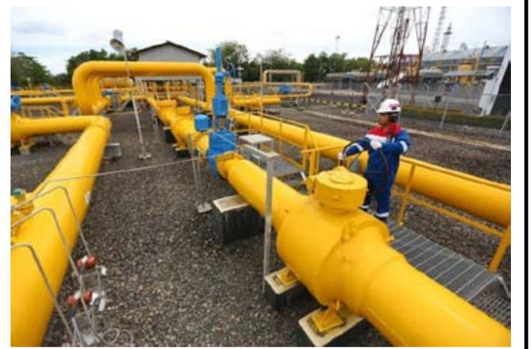
印尼国有燃气公司的天然气管道基础设施。
