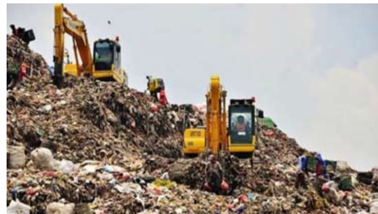
图为西爪哇省勿加西市班达尔格邦区Sumur Batu垃圾填埋场的垃圾堆积状况。
