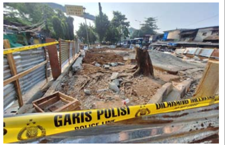
一名4岁的男孩在雅加达南区Tebet镇Manggarai村Manggarai Utara 11路的多功能公园施工期间坠入坑洞身亡, 事发时间为6月29日。
