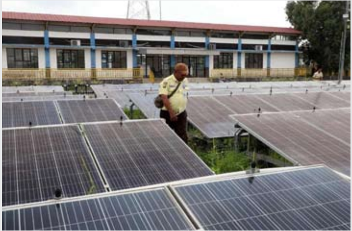
屋顶太阳能电系统 (PLTS)。
