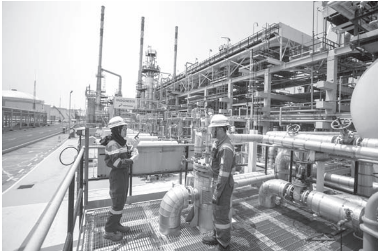
9月10日，工作人员在印尼中爪哇省芝拉扎炼油厂1号原油蒸馏装置进行现场巡检。
